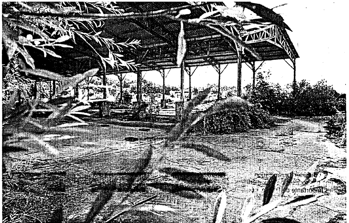
Distré, hameau de Munet. Une plateforme en béton usagée, des hangars à l'abandon, l'ancien site de France-Champignon va bientôt produire de l'électricité.
